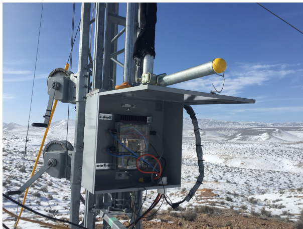
図 2.16: 中央データ収集塔に設置されている、タワーエレクトロニクス
