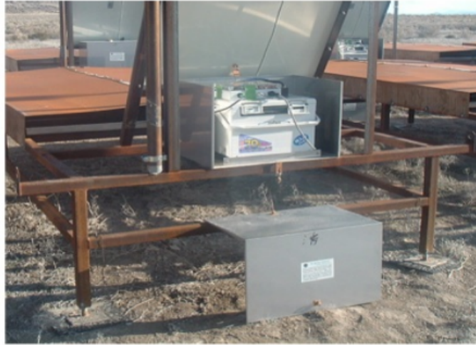
図 2.10: ソーラーパネルの裏の箱に SD エレクトロニクスとバッテリーが格納されている。
