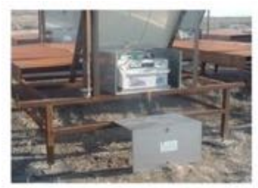
図 2.3 SD を背面から見た図. ソーラーパネルの後ろ側にエレクトロニクスとバッテリーが入った箱が取り付けられている.
