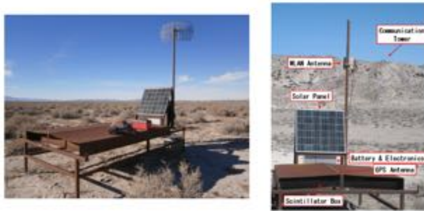
図 2.2 TA 観測サイトに設置されている Surface Detector(SD). SD の概観 (左図) と各部の説明 (右図).
