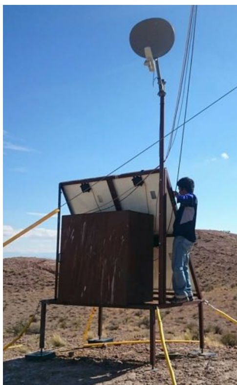
図 4.6: タワーにおけるソーラーパネル裏の箱の外観
