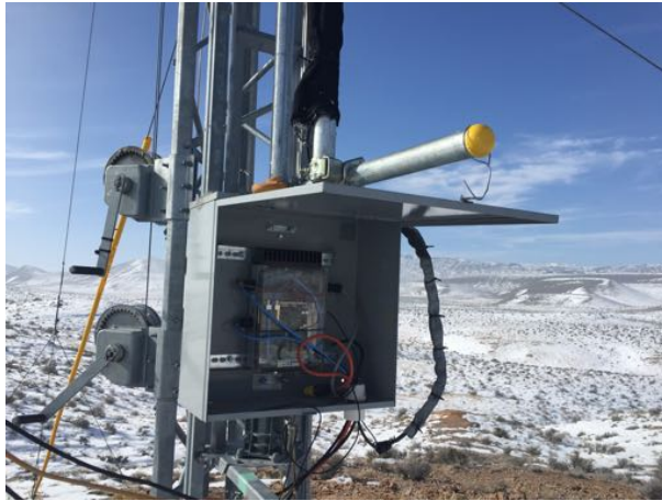
図 2.17: 中央データ収集塔に設置されている、タワーエレクトロニクス
