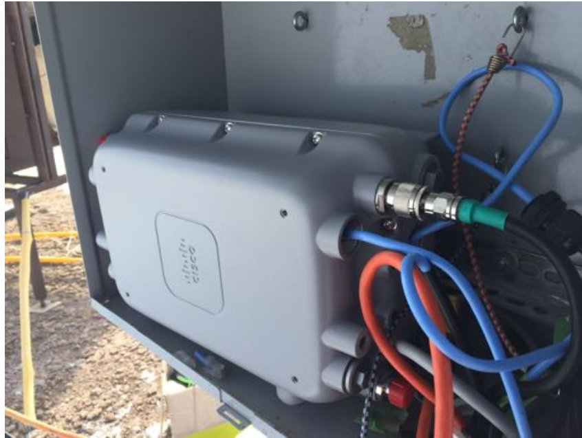
図 4.4: アクセスポイントはタワーの昇降可能な箱の中に設置される。
