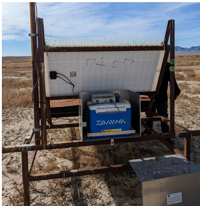
図 2.6: SD のエレクトロニクスボックスの外観。蓋を開けた状態である。クーラーボックスの中にバッテリーが、その上にエレクトロニクスが格納されている。
