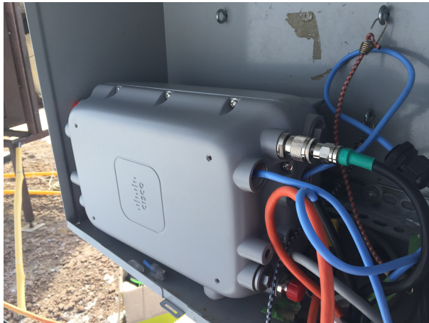
図 2.13: 昇降可能な箱の中に収められているアクセスポイント
