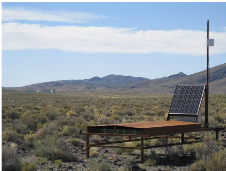
図 2.9: 現在設置されている TALE-SD。茶色の屋根の下にシンチレータボックスが格納されている。
