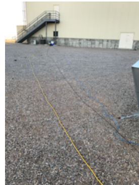
図 3.25 BRM ステーションとエレクトロニクスをつなぐケーブル。左から、電源, トリガー, ネットワーク。
