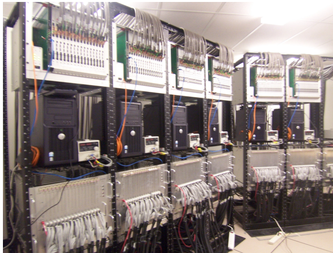
図 3.9: 現地のステーション (BRM) 内に設置されたエレキ群
