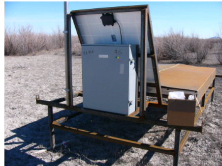
図 3.25: 地表検出器を背面から見た写真。ソーラーパネルの後ろにエレクトロニクスを収容している箱が取り付けられている。
