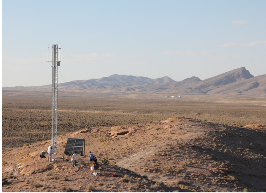
図 2.12: TALE 実験用の無線 LAN タワー. 太陽パネルにより電源供給している. 写真の右奥には MD/TALE-FD ステーションが小さく写っている.
