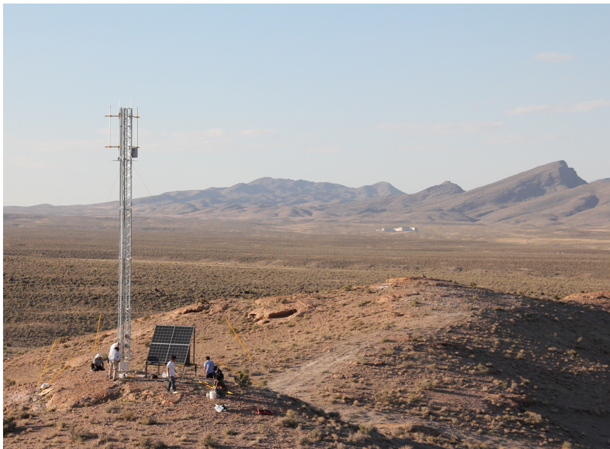
図 2.13: TALE 実験用のデータ通信塔。太陽光パネルにより電源を供給している。中央右奥に MD/TALE-FD ステーションが小さく写っている。
