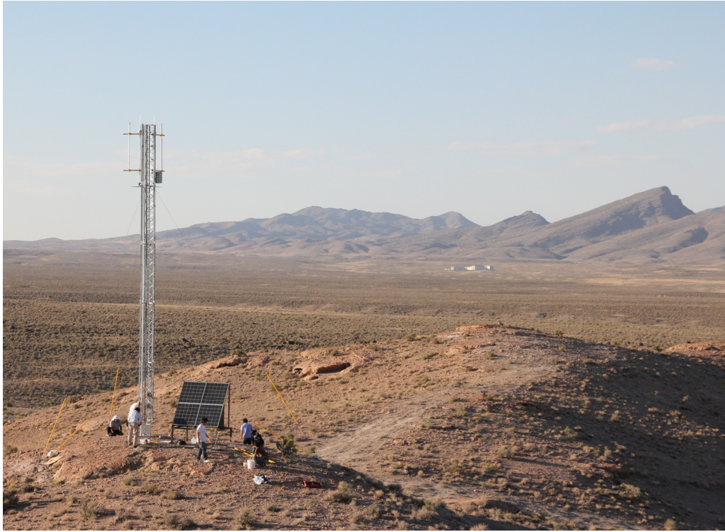
図 2.30: TALE 実験の SD アレイのための中央データ収集塔
