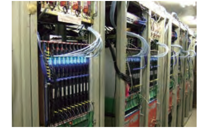
New electronics connected to new DAQ system 新しいデータ収集システム
