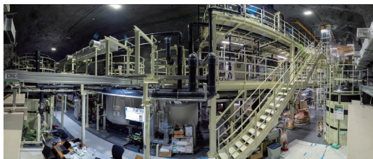
図4. ガドリニウム水システム
