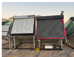
図 2. 新たに設置した電動シャッター(右)。夜間もスカイモニターで確
