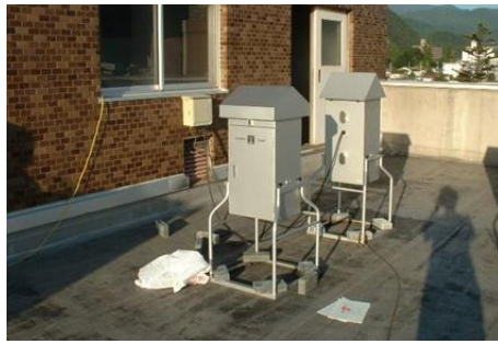
写真 1. 山形大学理学部屋上に設置したハイボリューム・ エアーサンプラー
