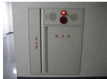
火災報知器（上）と消火栓（下）
