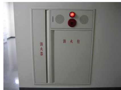
火災報知器（上）と消火栓（下）
