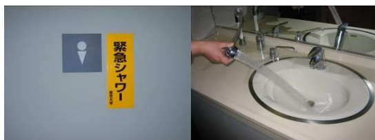
トイレに設置
