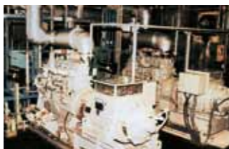
自家発電機 Power generator
