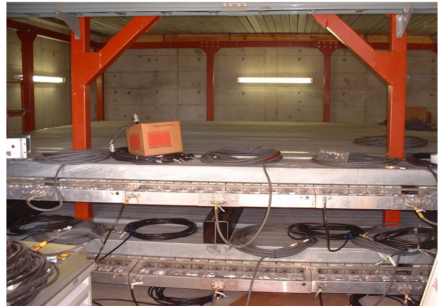
ミューステーション(M5)内部
