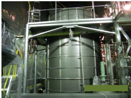
図 2 : CANDLES III システムに導入した \gamma 線遮蔽システム。中性子捕獲からの \gamma 線を遮蔽するために設置した。写真は、最上部まで遮蔽材を設置した状態の様子。鉛の厚みは 7～12cm。
