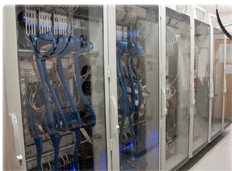
図 5 : 回路アップグレード後の回路室。
