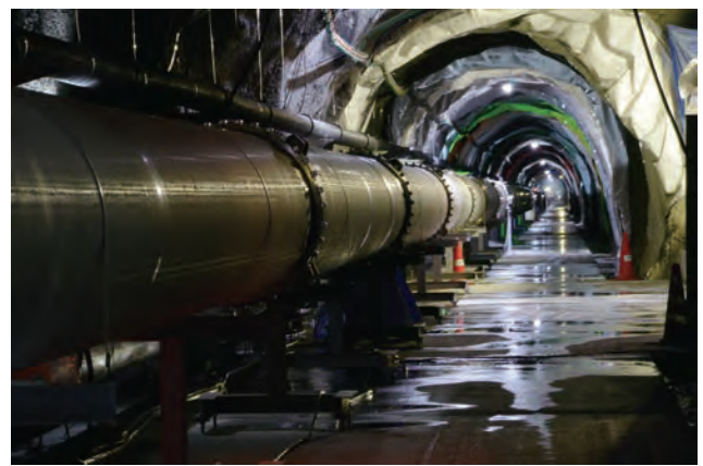
図3：3kmの腕トンネルに設置された真空ダクト。長さ12m、直径80cmのダクトを約250本程度締結し、約3kmの高真空空間を構築。写真はXアーム(佐古西側に伸びるトンネル)。
