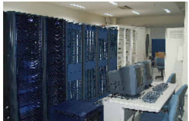
Fig. 1 新計算機システムの全景。左から計算サーバ装置、ファイルサーバ装置、45 TB 磁気ディスク装置（ラック4台）、計算サーバ装置の一部（ラック3台）、200 TB 磁気テープライブラリ装置。この後ろにラック10台分の計算サーバ装置がある。
