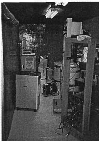
地下観測室の様子
